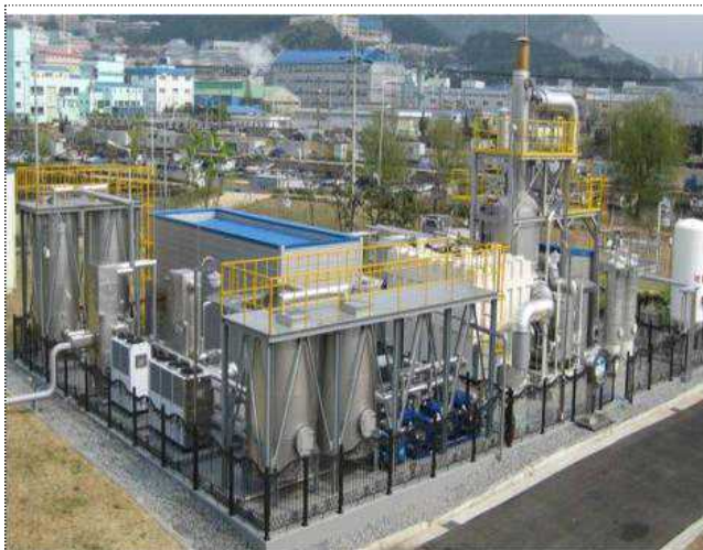
부산강변 바이오연료전지 발전소 1.2MW
