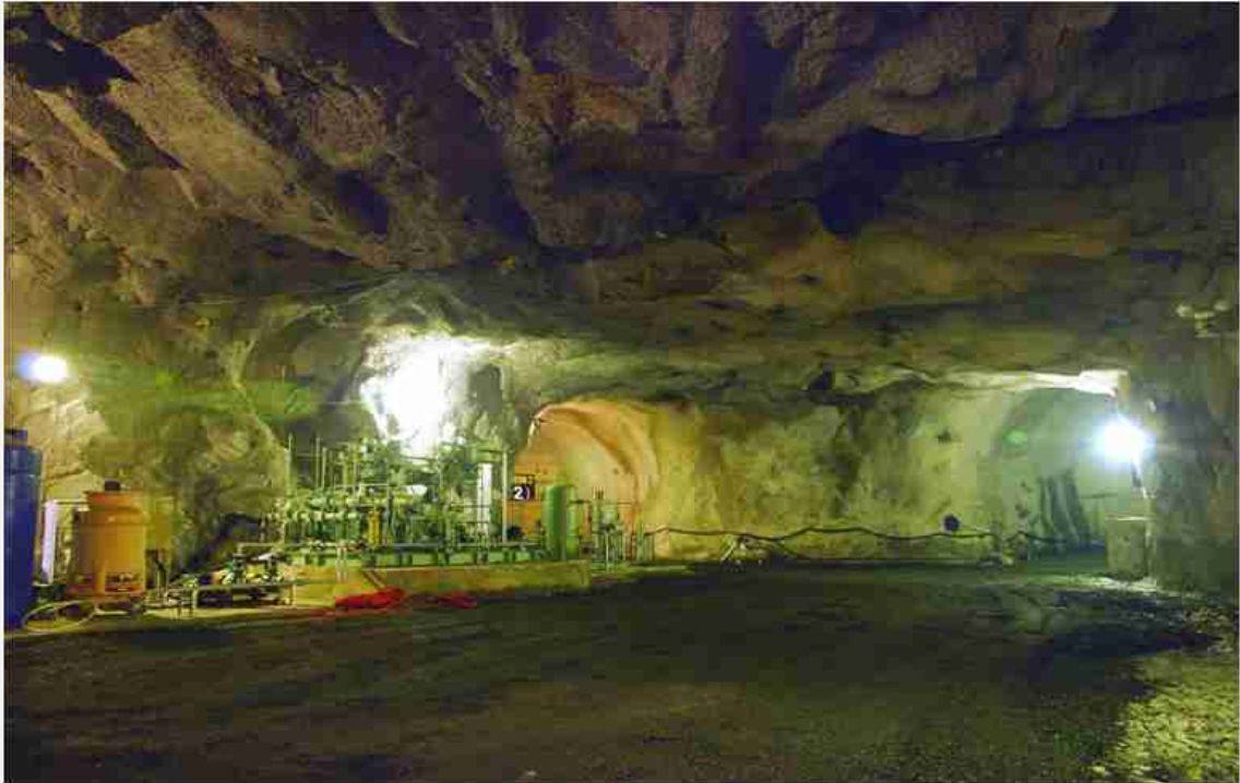
<그림 6. 한국지질자원연구원에서 구축한 CAES Pilot Plant 지하시설>
